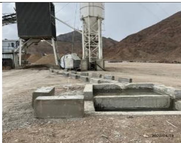
Фото 59. 3-камерный резервуар первичной очистки сточных вод БСУ Лот 1.
