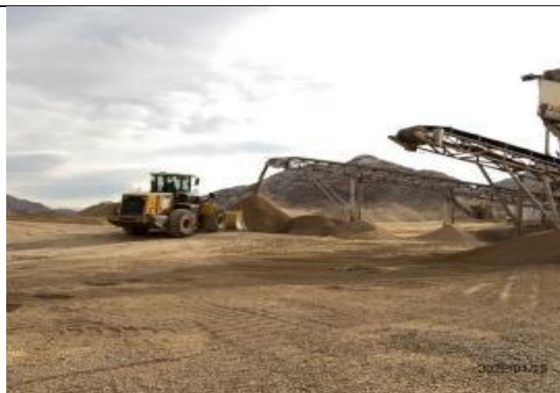
Фото 42. Лот 1 Дробильная Установка.
