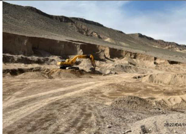
Фото 68. Методика разработки грунта на км71+500 не соответствует требуемому углу для устойчивости и безопасности.
