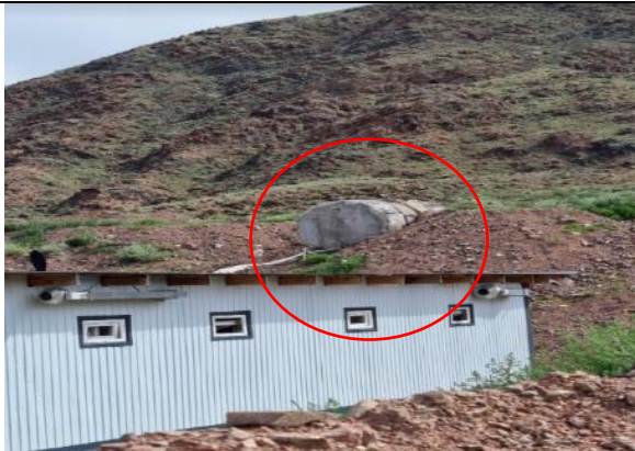
Фото 39. Резервуар бытового водоснабжения (встроенный).
