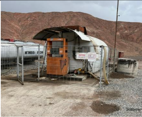
Фото 63. Разливы ГСМ на грунт.
